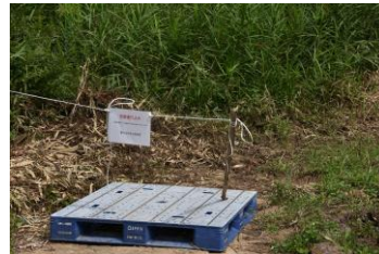
橋が壊れて危険看板
